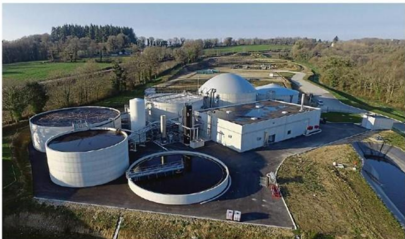
Un osmoseur sur mesure a complété le réseau alimenté par la station d'épuration de l'usine du Fauoët, dans le Morbihan. DR
